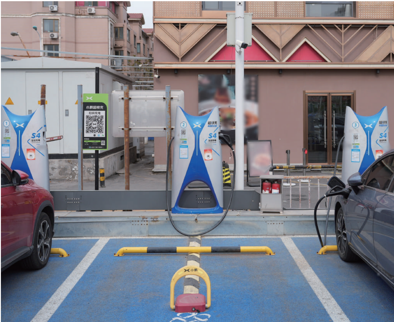
图：小鹏充电站内安装了防止非充电车辆占位的地锁
