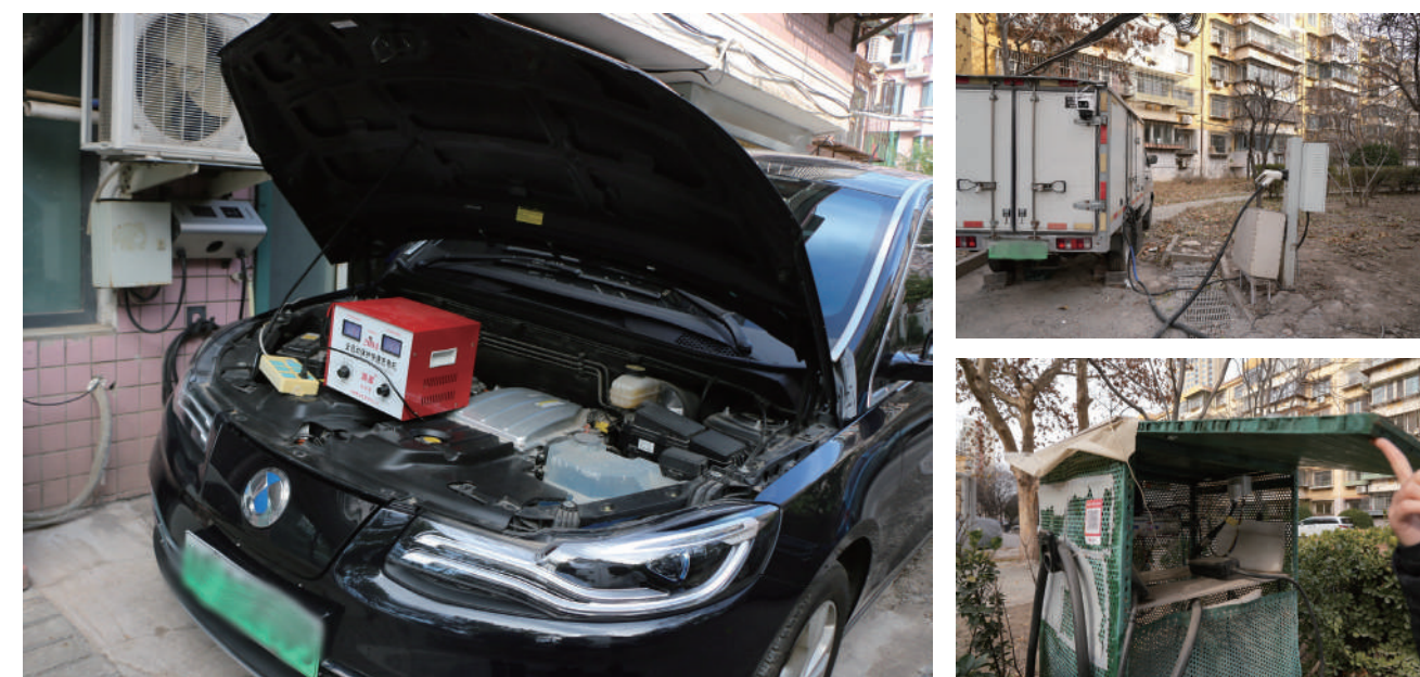
图：私接电线给车辆充电，存在较大的用电安全隐患
