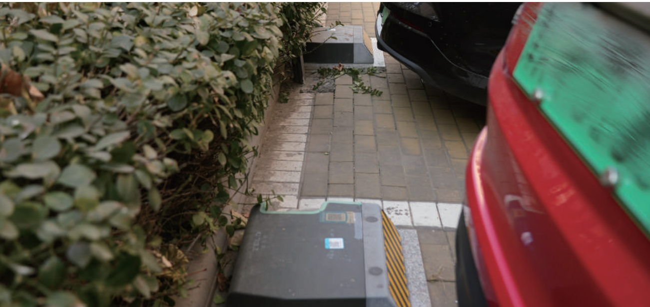
图:某社区公共充电站内安装了车挡式充电桩
